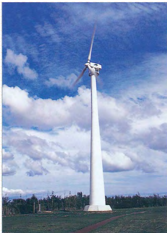
石狩放水路風力発電設備
