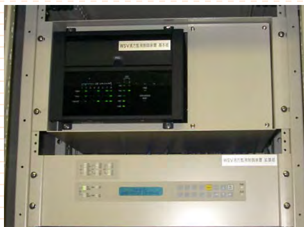
遠方監視制御装置
