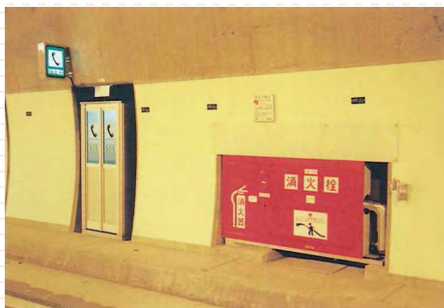
トンネル内非常警報装置、消火設備及び非常電話
