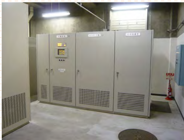
鹿ノ子ダム無停電電源設備
