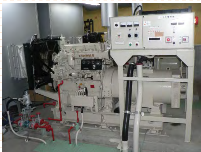
山本排水機場 自家用発電発電機
