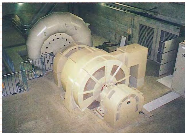
滝里ダム小水力発電設備
