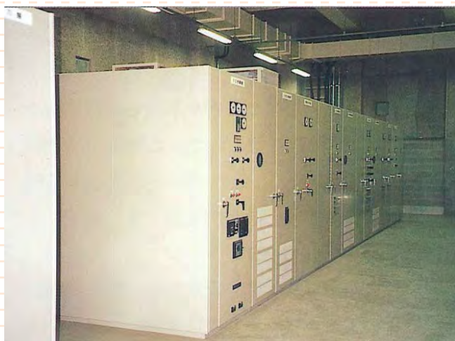
滝里ダム受変電設備
