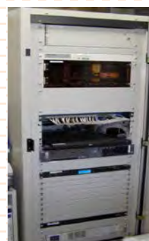
路側放送設備
