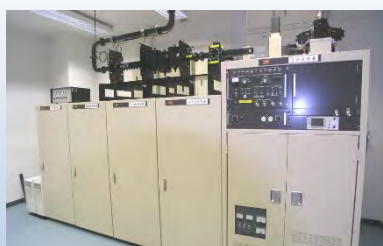
レーダ送受信装置 レーダ雨雪量観測所機器
