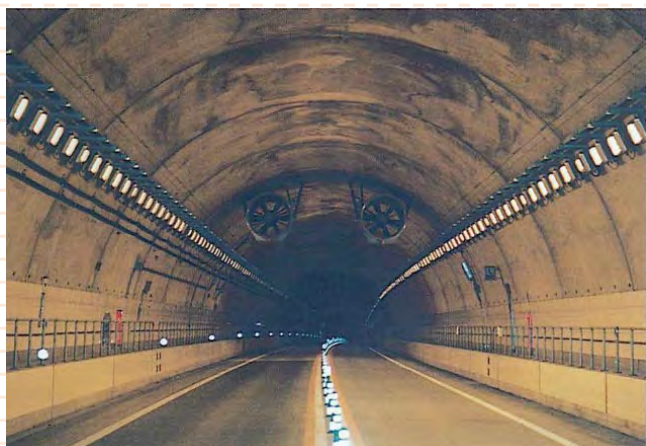
旭川紋別自動車道北大雪トンネル換気設備及び照明設備
