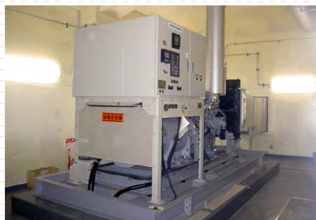
定山溪トンネル自家用発電発電機
