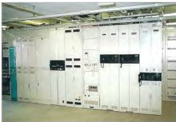
多重無線通信設備
