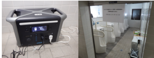
図-18 道の駅トイレ棟の設備への給電の様子
