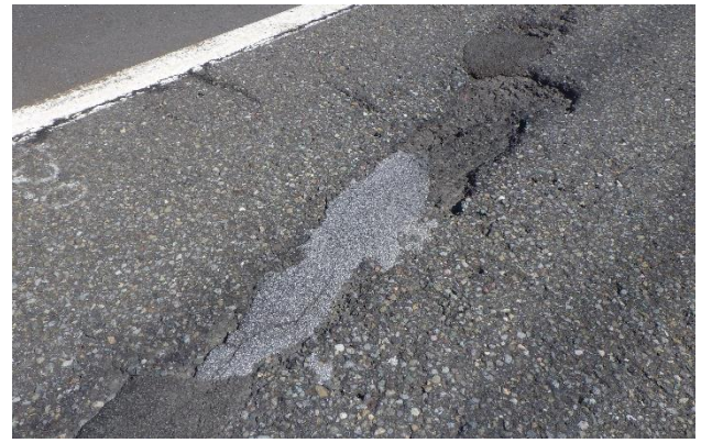
写真-4 ひび割れ部のポットホール状の欠損の例
