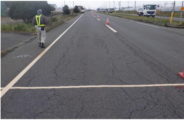
写真-3 施工前の路面状況（苫小牧市錦岡）
