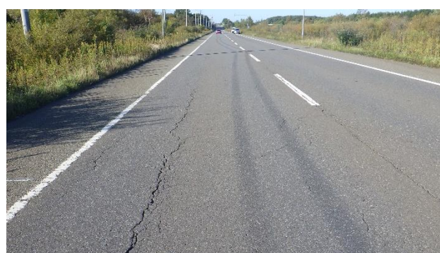
写真-2 施工前の路面状況（勇払郡厚真町）
