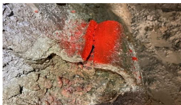
写真-9 鋼製支保工の変形
