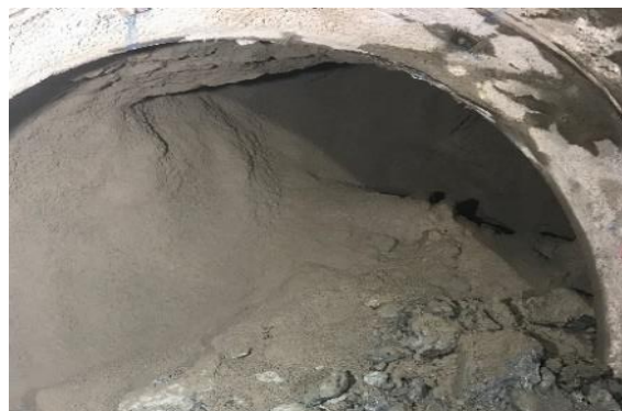
写真-2 天端の抜け落ち
