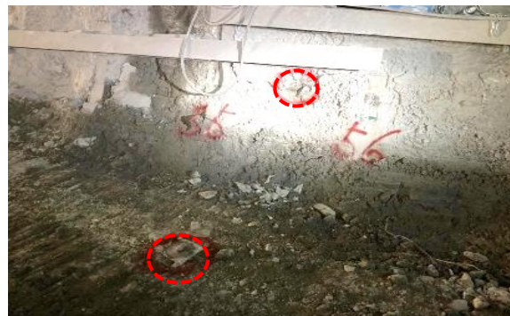
写真-8 ロックボルトの破断
