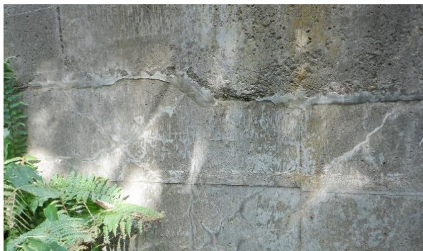
写真-3 亀甲クラック、鋼材方向クラック (ASRの可能性大)
