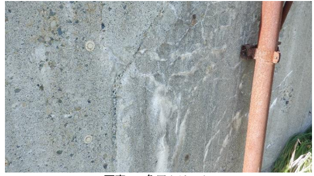
写真-4 亀甲クラック (ASRが疑われる)
