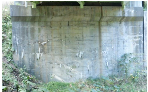
写真-5 鋼材方向クラック (ASRが疑われる)
