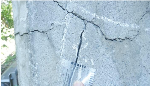
写真-2 亀甲クラック、ひび割れ段差 (ASRの可能性大)
