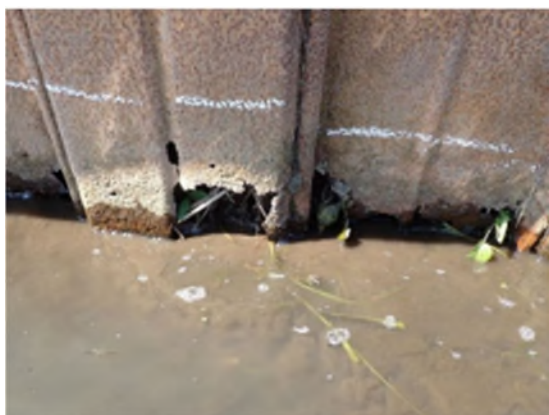
写真-2 干満帯の腐食
