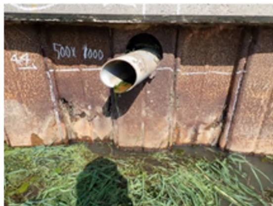
写真-4 干満部から開口部までの腐食
