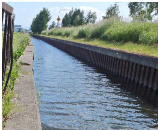
写真-5 傾倒による笠コンクリートの目地のずれ
