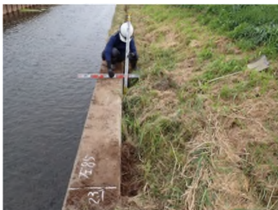
写真-3 吸い出しによる背面土砂の沈下
