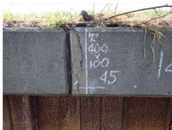
写真-6 笠コンクリート目地周縁の剥離欠損状況
