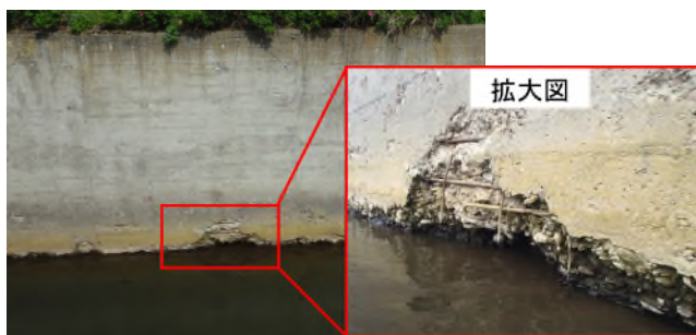
写真-2 トール沼切替排水路 コンクリート水路の欠損状況
