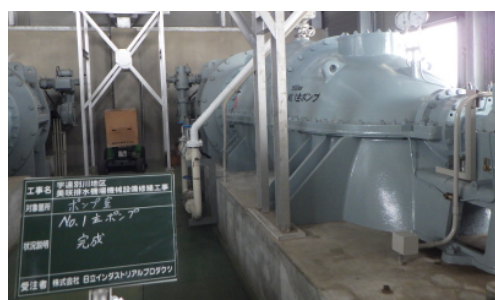
写真-3 美咲排水機場 主ポンプ設備（整備後）
