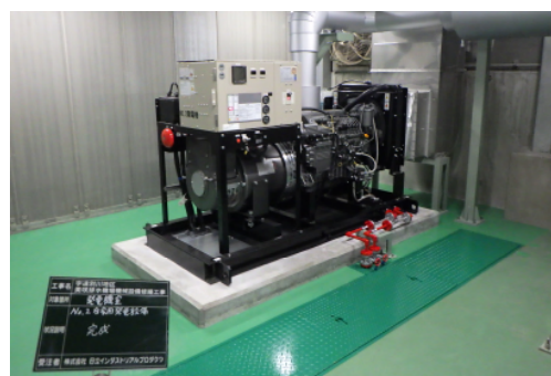
写真-4 美咲排水機場 自家発電器（整備後）
