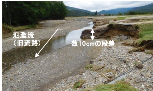
図-5 旧流路付近の農地の侵食状況
