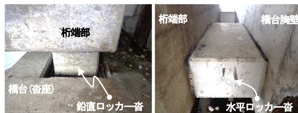
写真-2 コンクリートロッカー脊の状況
