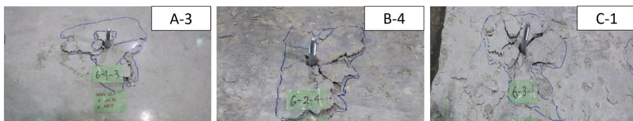
写真-5 アンカー引抜試験後の破壊形態
