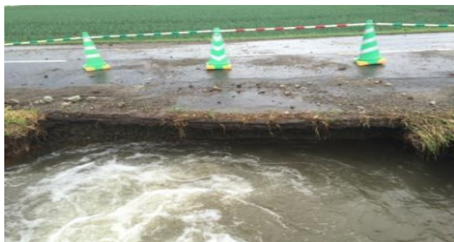
写真-1 漏水事故により市道の一部が流亡
