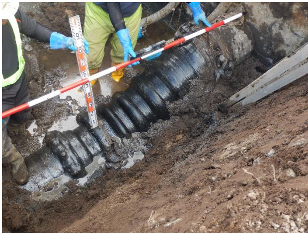
写真-2 500mmの沈下を生じた可とう管
