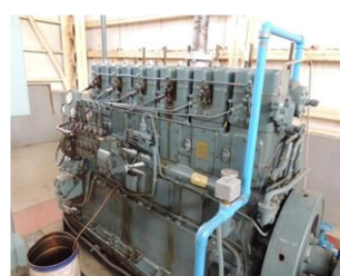
【ポンプ設備：エンジン油漏れ】
