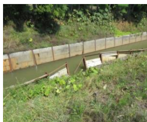
【柵渠の倒壊・傾倒】
