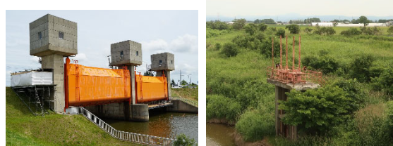
写真-2 高彩度色で塗装された土木施設。塗装ムラや錆、塗装剥がれなどの外観への影響が顕著に表れる
