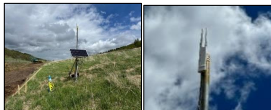
写真-1 メッシュWi-Fi設置状況
