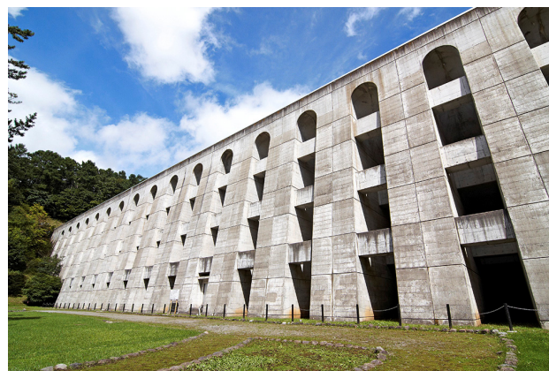
写真-1 笹流ダム（北海道函館市）にみるコンクリート面の汚れの発生傾向（提供：土木学会北海道支部）
