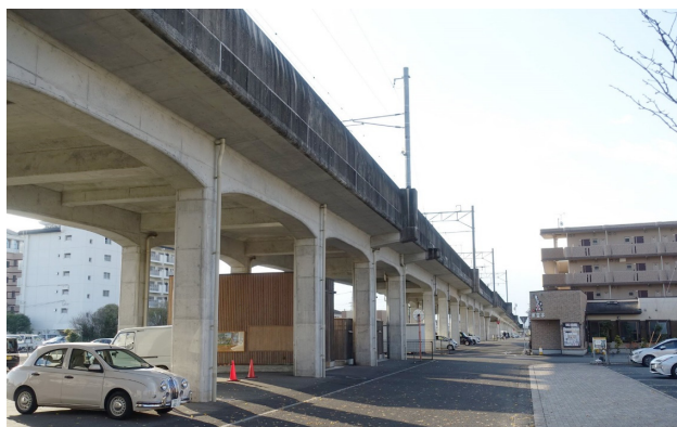
写真-2 鉄道高架橋の壁高欄および水切り以下の橋桁橋脚部分における汚れの発生傾向
