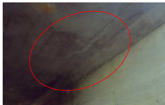
写真-4 朝日樋門 函体頂版部のひび割れ
