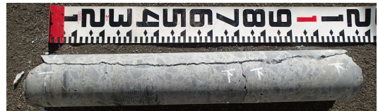
写真-2 下流面から採取したコンクリートコア
