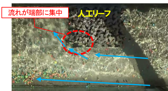
写真7 波浪種類ごとのブロックの被災状況 (ケース3-1)
