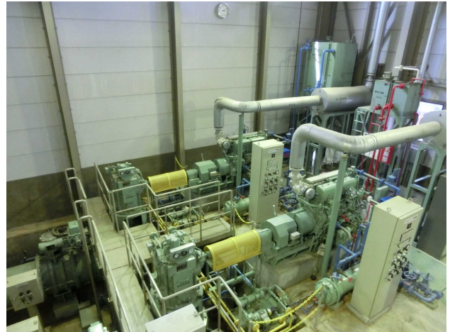
図-8 赤平排水機場機械設備
