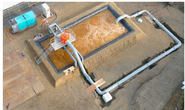
写真-3 試験用設備仮設後の試運転状況
