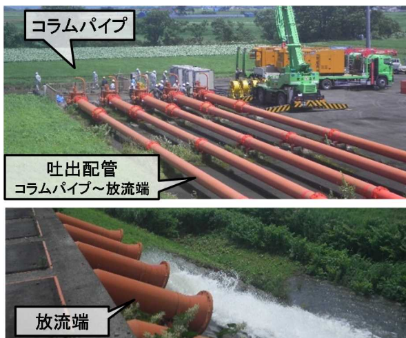
写真-1 救急排水機場 (北海道滝川市)
