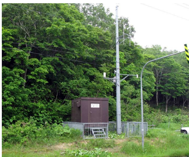
写真-1 道路テレメータ設備
