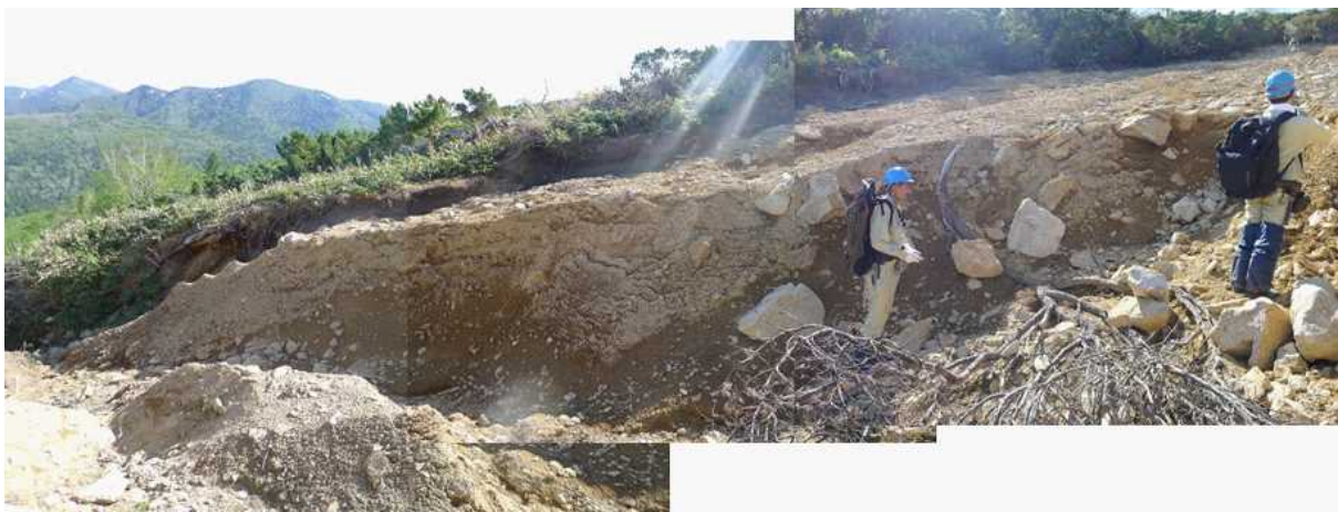
図-3 表層崩壊発生箇所（上流側崩壊地）の現地状況
