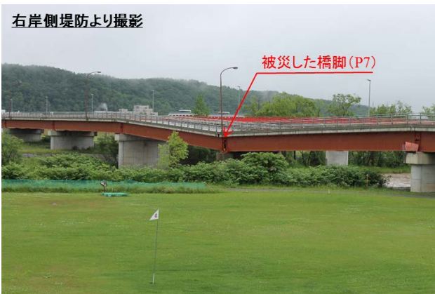
写真-1、写真-2 被災時の状況
