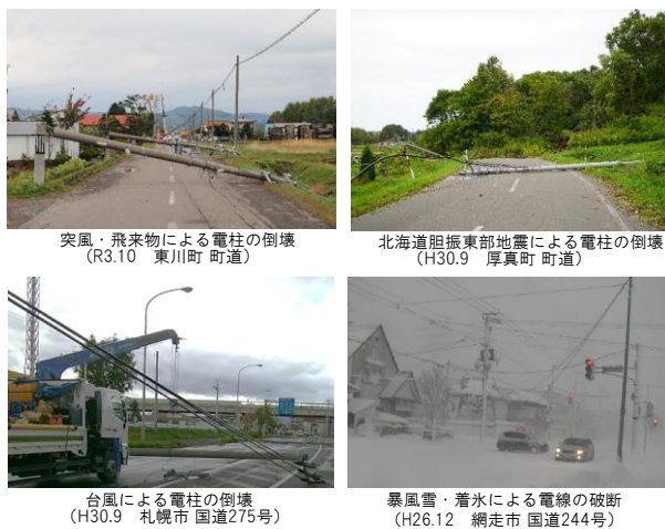
写真-2 自然災害による電柱倒壊・電線破断
