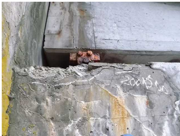
写真-1 ASRと凍害の複合劣化と診断された橋台の例
