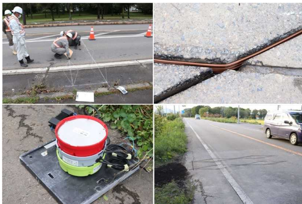
図-6 自転車交通量観測用センサーの設置状況
