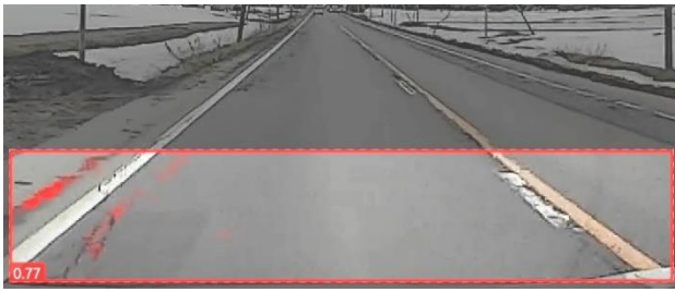
図-5 誤検出の例(偽陽性、路肩部水濡れをポットホールと誤認)
