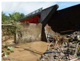
図-1 豪雨災害により橋台背面土が流出した事例
