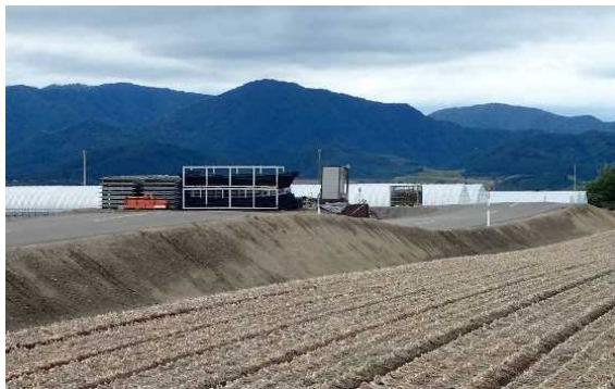
写真-1 農道の沈下状況
