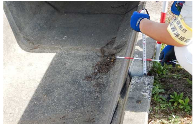
写真-2 6区第1用水路の沈下箇所
