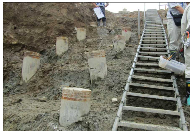
写真-5 基礎杭の折損状況（全景）
