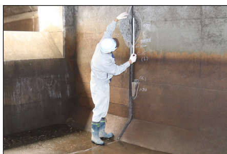
写真-1 損傷状況 (図-4の①)
