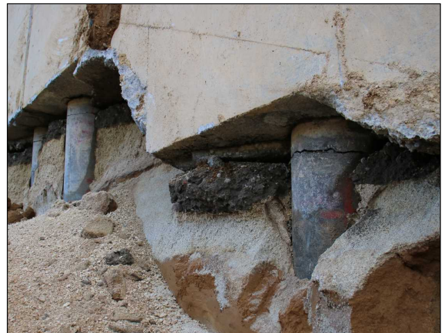
写真-4 基礎杭の折損状況（近景）
