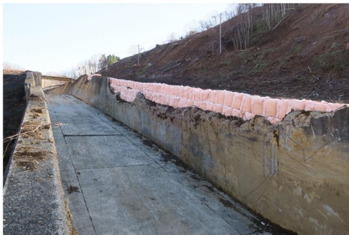
写真-1 洪水吐左岸側壁欠損
