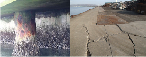
図-3 祝津岸壁の老朽化状況
