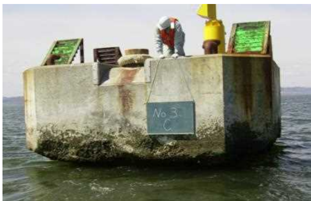
写真-1 氷海域におけるコンクリート構造物の劣化事例
