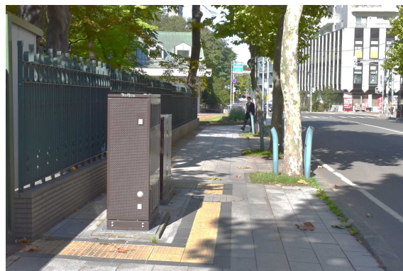
写真-1 地上機器が歩行や見通しを阻害している例
