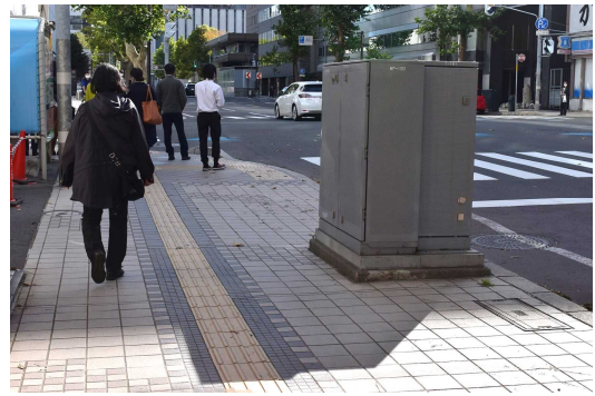
写真-2 最も多かった歩車道境界の地上機器
