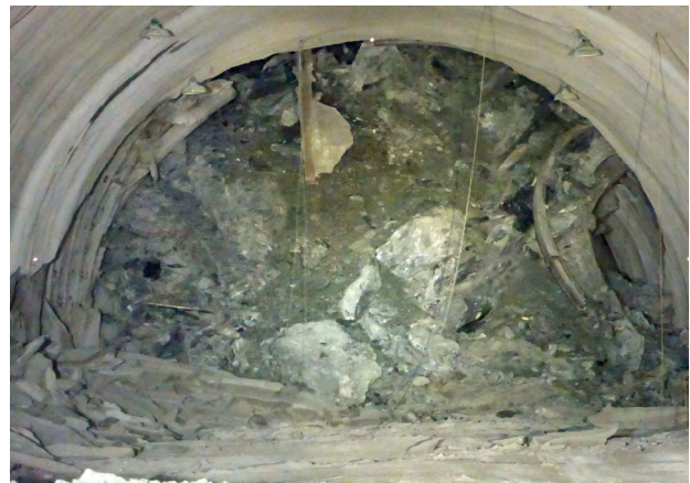
写真-2 天端崩落発生状況
