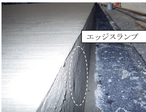
写真-3 無型枠でのエッジスランプ例
