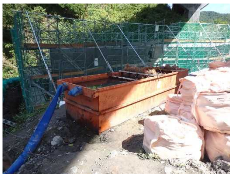
写真 3 ヤシガラフィルターを用いた貯水槽
