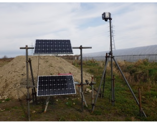
[ソーラーパネル設置状況]
