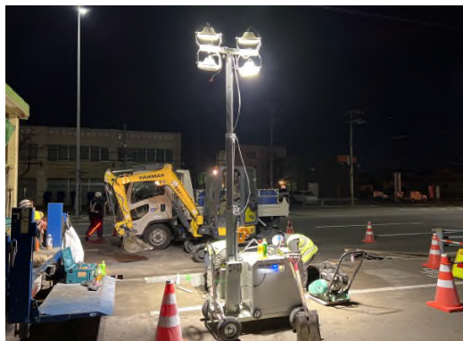
[現場内使用投光器]
