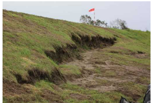
写真-1 釧路川で発生した堤防法面の被災
