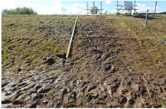
写真-4 試験後の堤防法面が高飽和状態の様子
