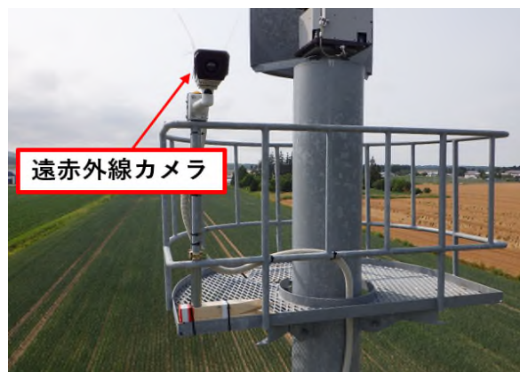
写真-5 遠赤外線カメラ設置状況 (高水敷用)
