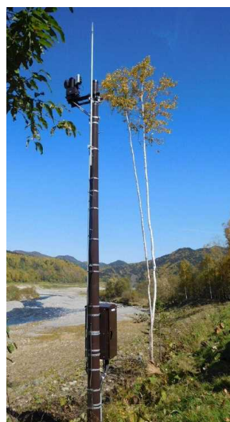
図1 CCTVカメラ設備
