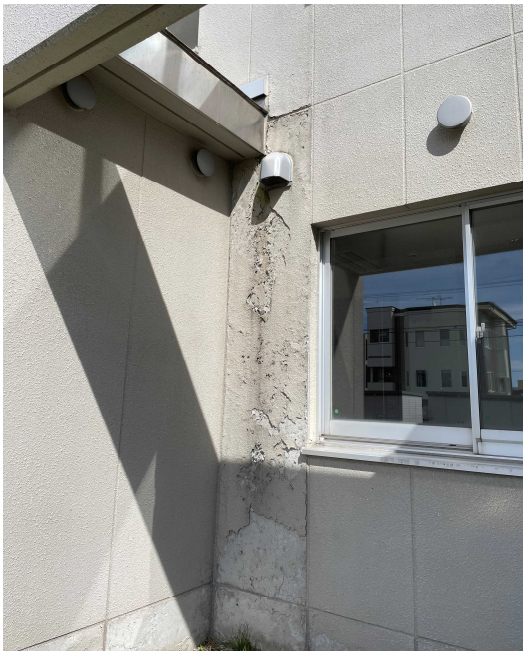
図-7 雨仕舞いが悪い部分の劣化状況
