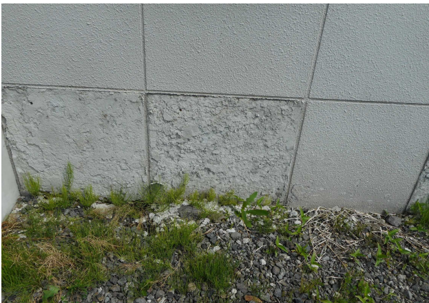
図-6 腰下部劣化状況
