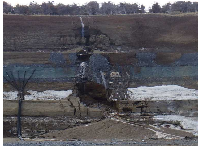
写真-11 湧水による損傷状況の写真
