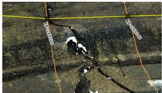
図-6 損傷箇所の3次元データ
