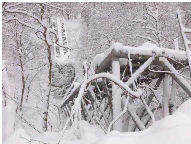
写真-1 美唄市水管橋の崩落状況 1) (2021年2月25日撮影)
