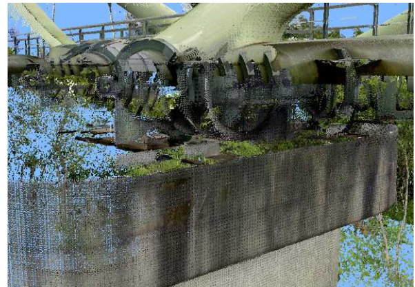
図-7 橋脚上部から下弦材の間のオクルージョン（機種B）
