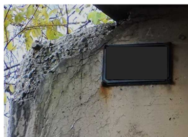
(a) ひび割れを伴う凍害劣化事例
