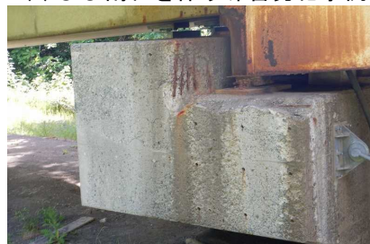
(b) スケーリング劣化事例
