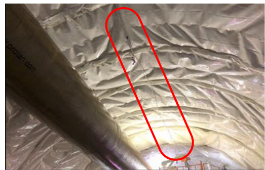
写真-3 吸引チューブ設置状況（赤枠部）
