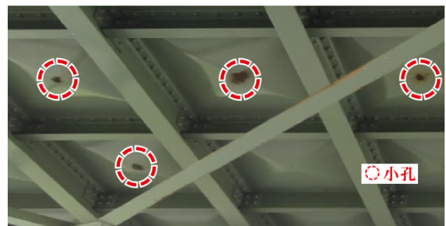
写真-4 バックルプレート（中央の小孔）
