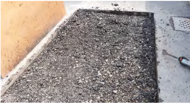
写真-5 アスファルト舗装(基層)の砂利化 (4 径間目)
