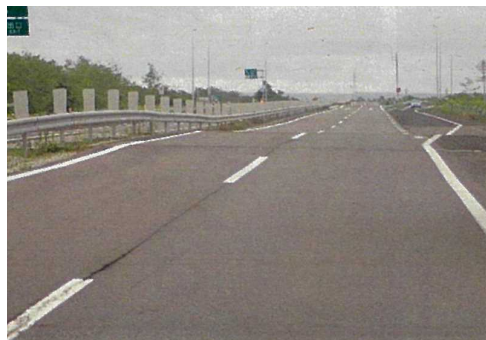
写真-1 道路盛土区間に発生した函渠工等周辺の段差状況の例
