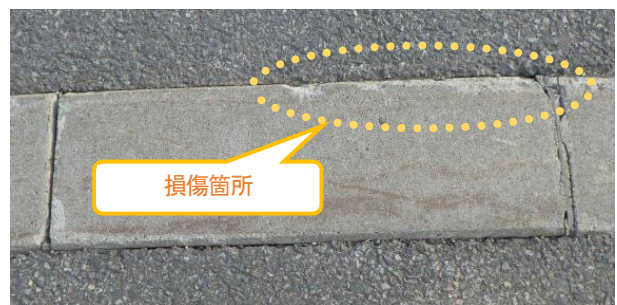
図-9 端部損傷状況 (テーパー型)
